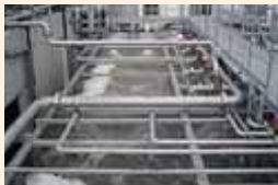
排水処理設備
